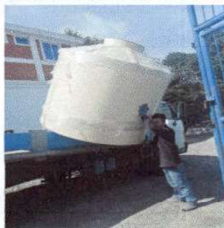
Foto 6: Recibiendo de el tanque de agua o rotoplast
